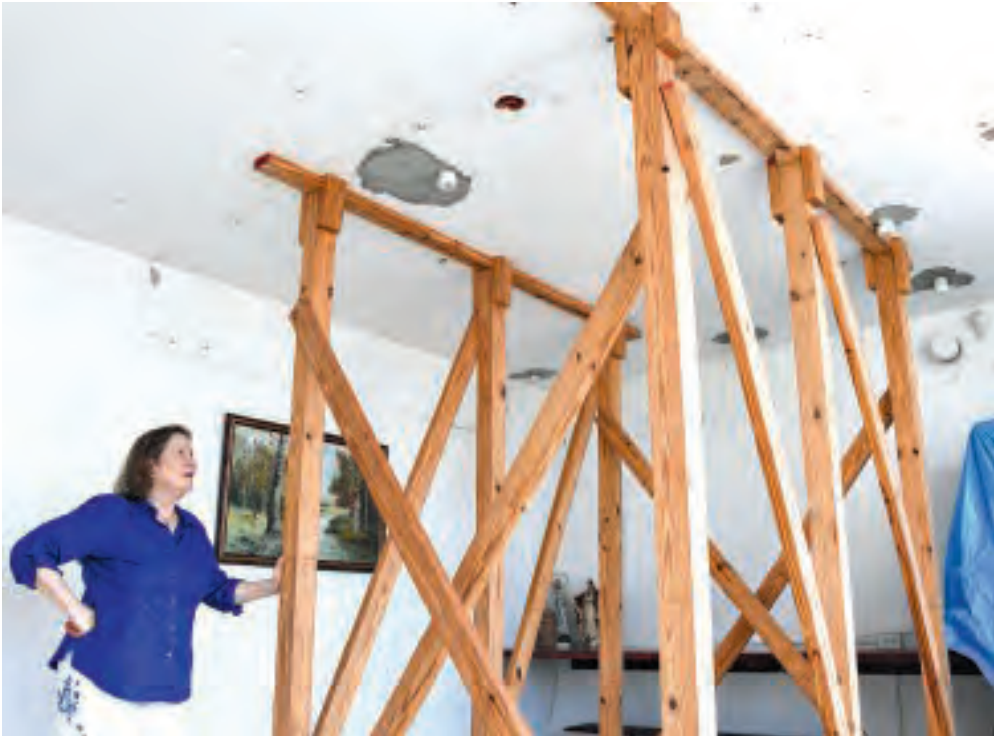
El techo del apartamento de Kathleen McGrath es sostenido con apuntalamientos de madera, que fueron colocados en 2015 por el Sistema Nacional de Protección Civil. Elysée Fernández
